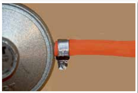
Slanganslutning vid reducerventil
